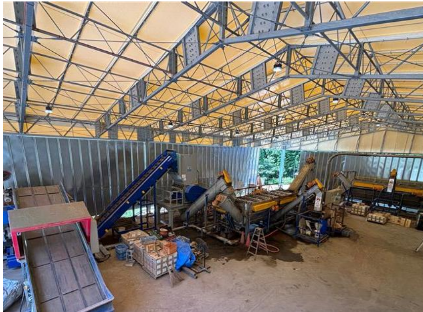
破碎・洗浄・脱水ライン
