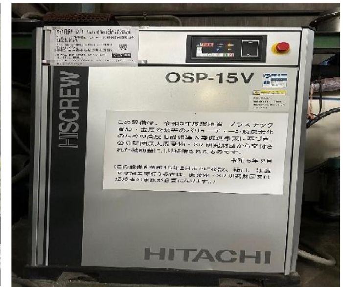
エアコンプレッサー
