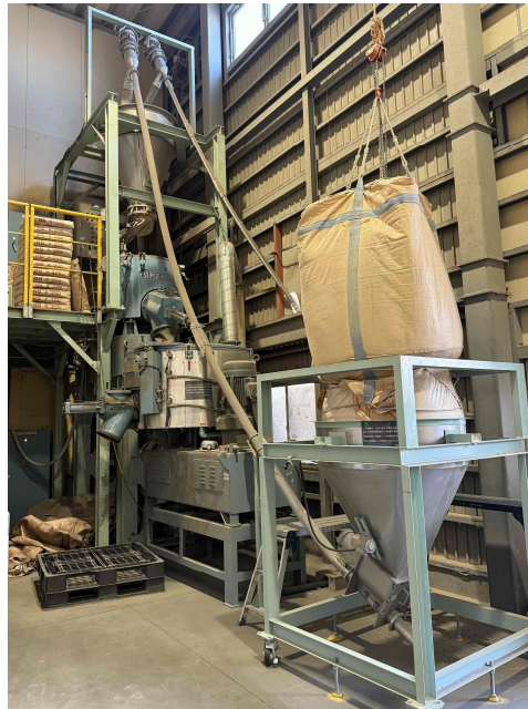
①自動計量器 ②混合機 ③冷却混合機
