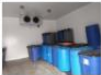
生ごみの冷蔵保存施設
