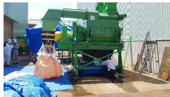
写真4 破碎・選別機
