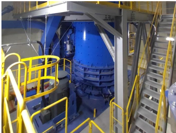
縦型破碎機（防音室内設置）
