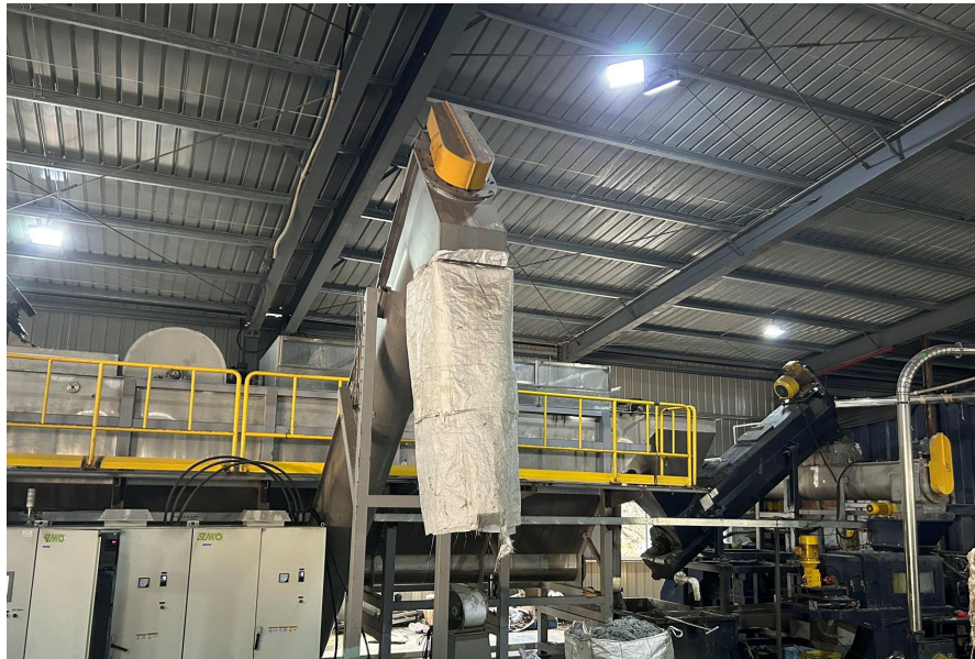
洗浄・脱水・減容ライン
