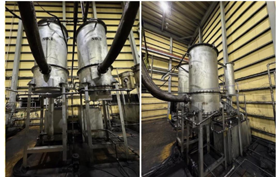
一次冷却器、二次冷却器（右側小さい方）
