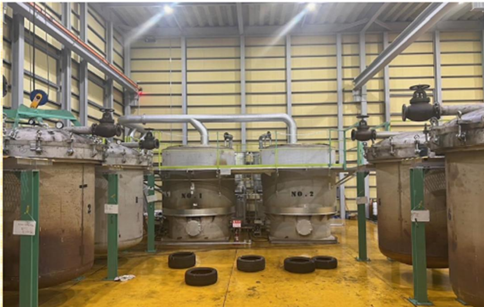
乾溜炉（中央2つ）と、取り換え用内窯（右側、左側）
