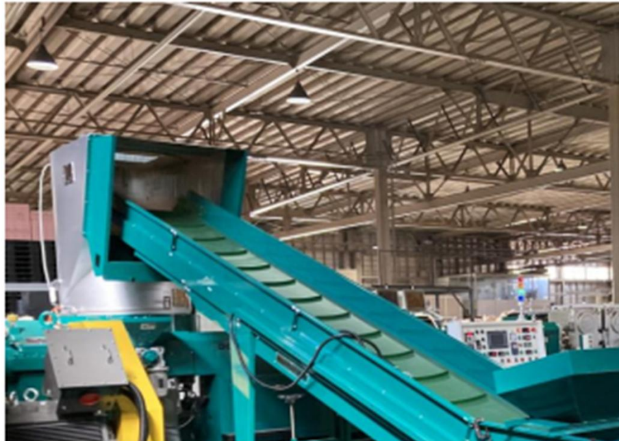
プラスチック再生機コンベアー
