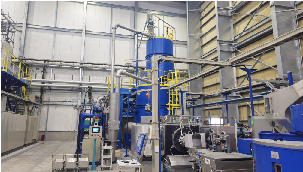
メカニカルリサイクル設備
