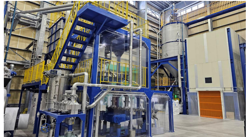
ペレット輸送設備
