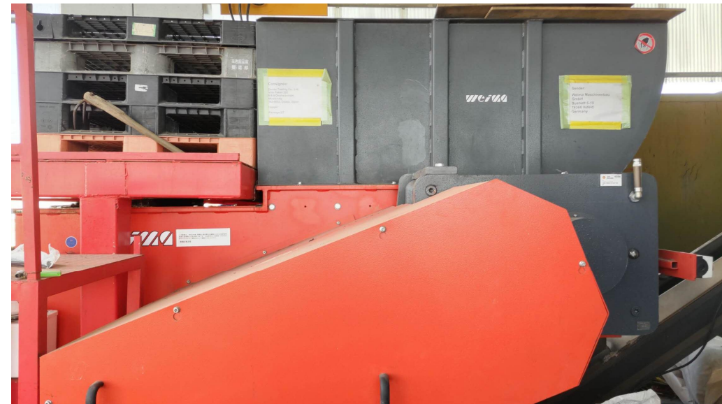
同破碎機 (側面)
