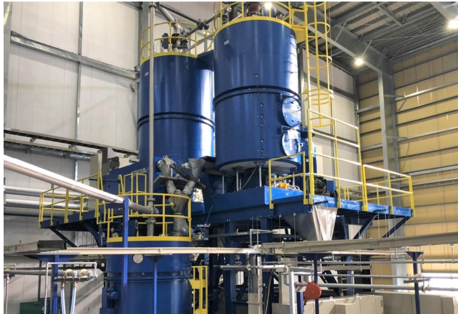
①メカニカルリサイクル設備
