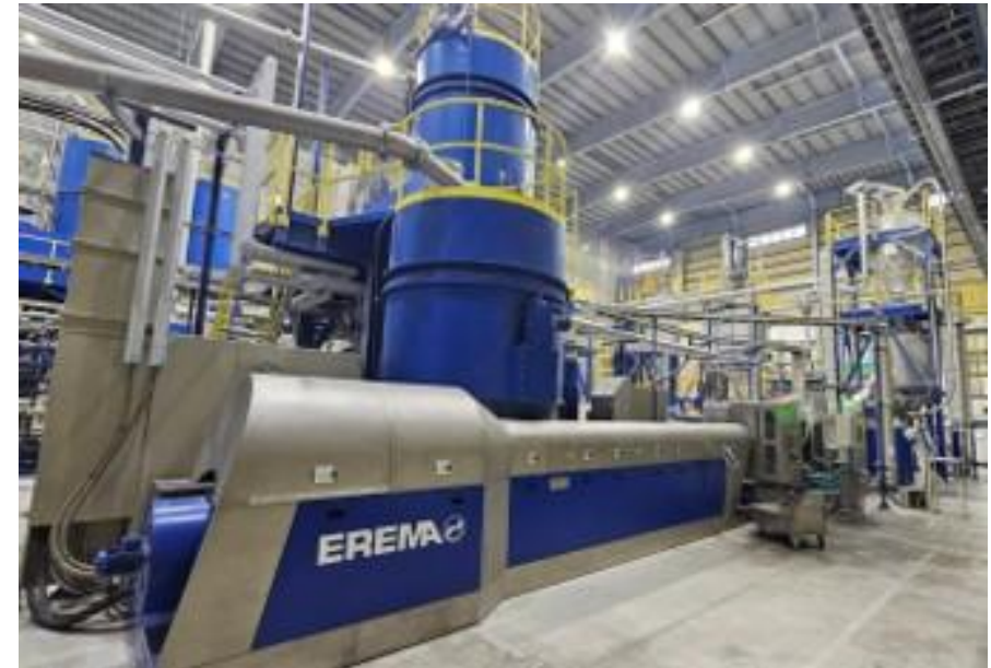
②メカニカルリサイクル設備
