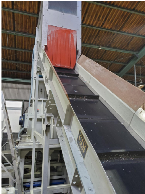
プラスチック投入ライン
