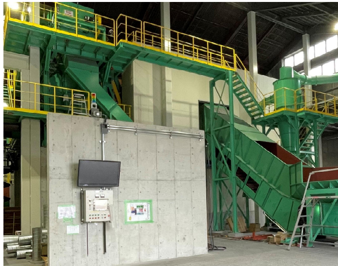
縦型破碎機（防音室内設置）
