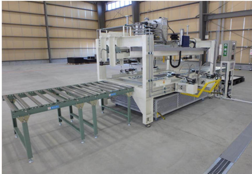
アルミフレーム解体設備
