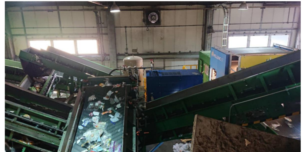
搬送コンベア
