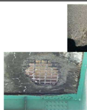
(床版下面) 床版の抜け落ち
