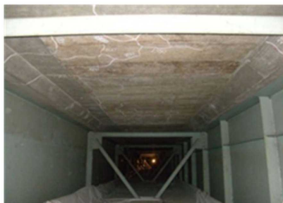
ひび割れの発生
