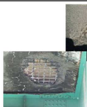
(床版下面) 床版の抜け落ち
