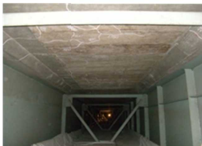
ひび割れの発生
