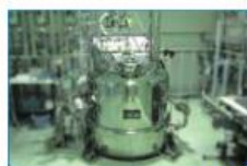
<バイオマスプラスチック製造設備>
