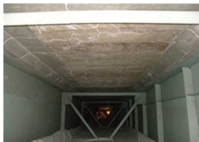
ひび割れの発生
